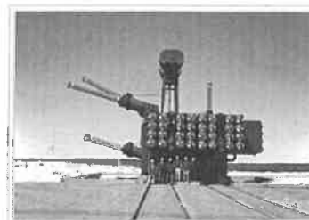
Stromrichtertransformator für eine Phase. Oben Ausgleichsgefäß für Kühlmittel. Links die langen Isolatoren der Anschlüsse auf der Gleichspannungsseite, nur diese reichen montiert durch die Wand in die Converterhalle zu den Thyristortürmen. Der Transformatorcorpore samt Kühler befindet sich im Außenbereich. Rechts oben der Anschluss für die Freileitung.
